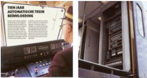
Links: ATB in de stuurcabine van een Sprinter en rechts de relaiskasten op het 'balkon' van een Sprinter.
